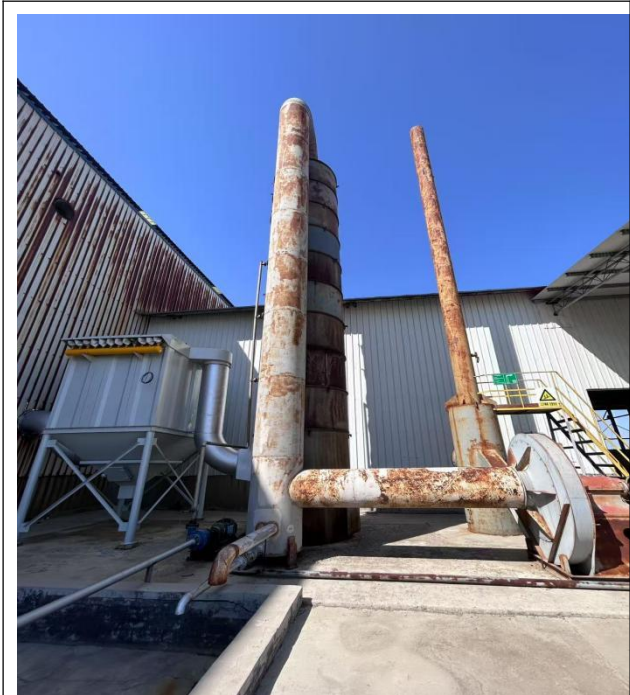
流化床加热炉废气处理设施：喷淋塔
