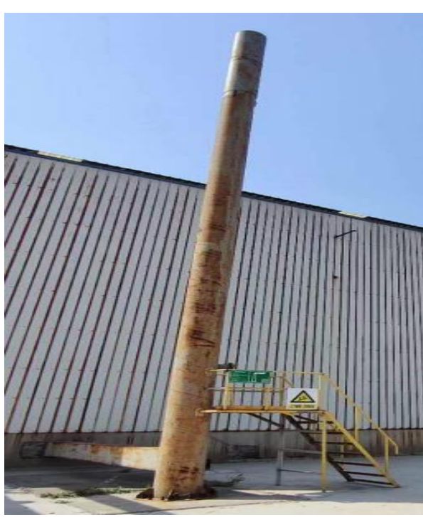
导热油炉废排气筒DA004
