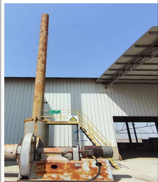
流化床加热炉排气筒DA001
